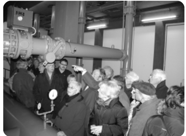
im Pumpwerk Mäder
