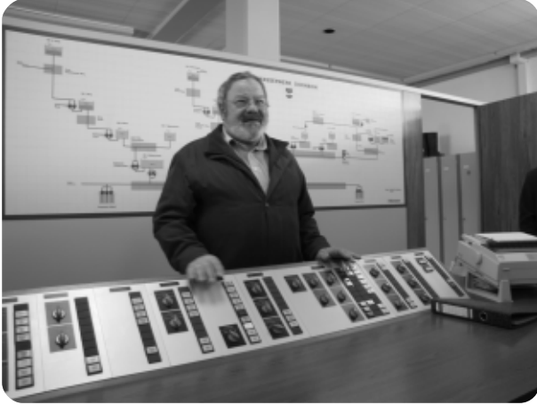
Steuerungszentrale in Dornbirn
