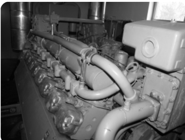
Schiffsdiesel als Notstromaggregat
